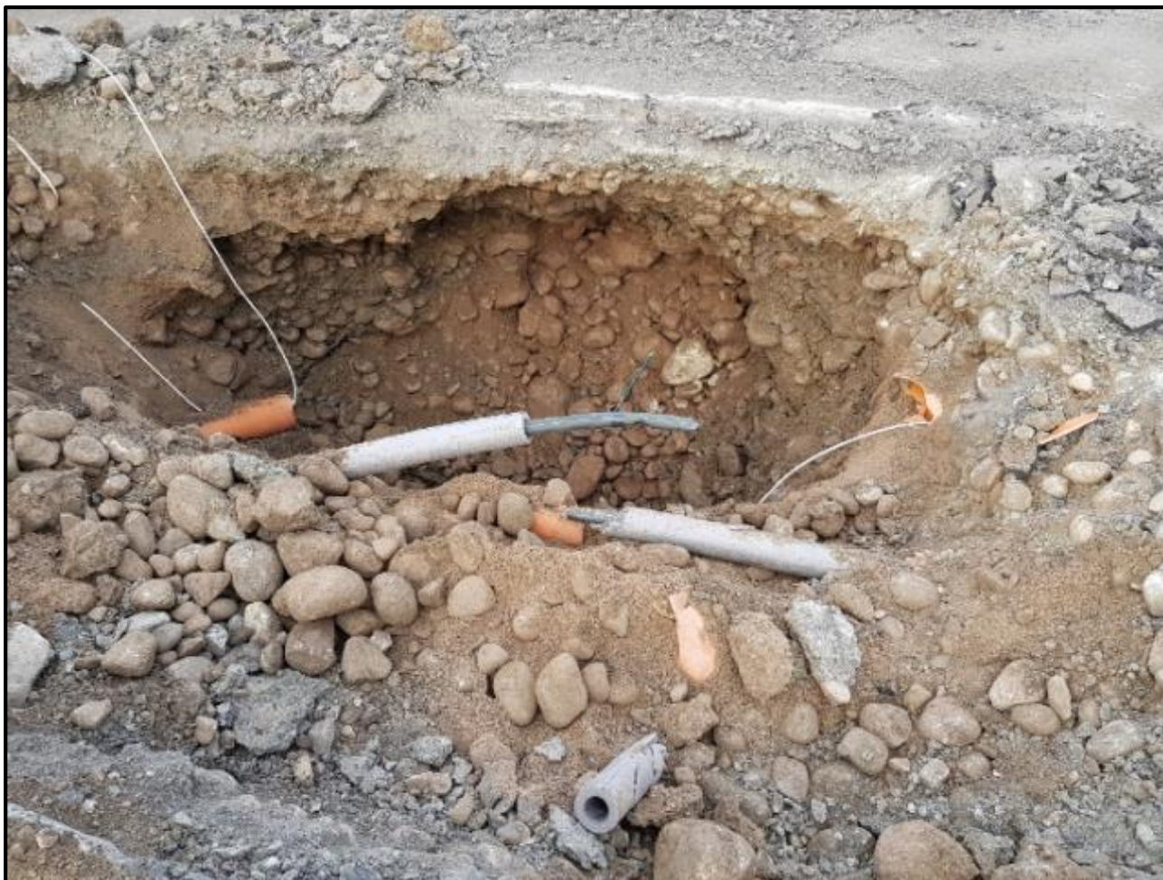
Figur 2: Bild över provgrop 17GAPG09. Den trycklösa avgrävda vattenledningen syns centralt i bild.
