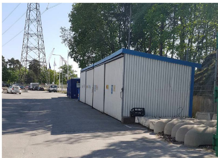
Figur 9: Container utomhus för förvaring av gasolflaskor. I halva containern förvaras tomma flaskor i den andra halvan fulla flaskor
