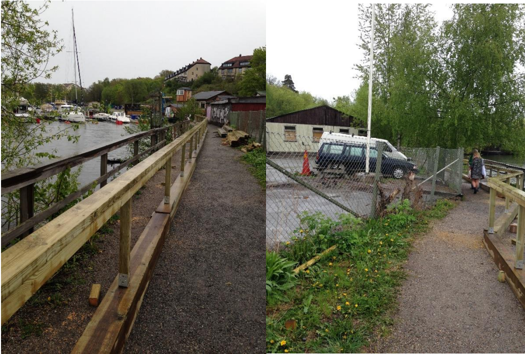
Bild 13 och 14. Strandpromenaden är i behov av upprustning.
