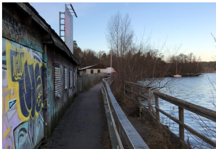
Foto på befintlig strandpromenad som är avsmalnad eftersom yttre delen har betydande sättningsskador.
