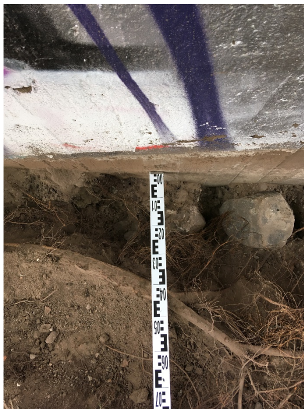
Bild 26 Roten växer 30 cm som närmast från muren
