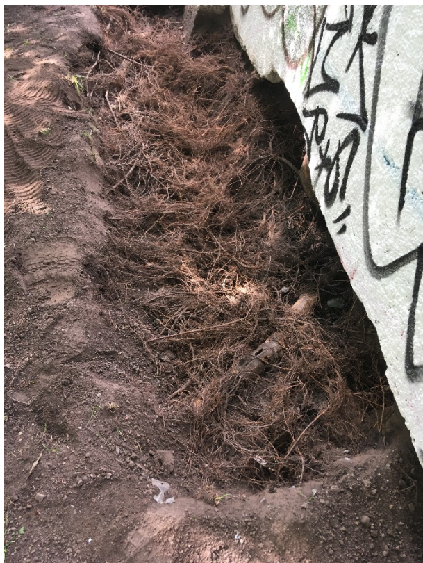
Bild 17 Fina rötter växer in under muren
