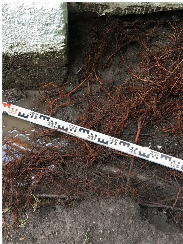
Bild 18 En rot ca 5 cm i diameter växer snett mot muren
