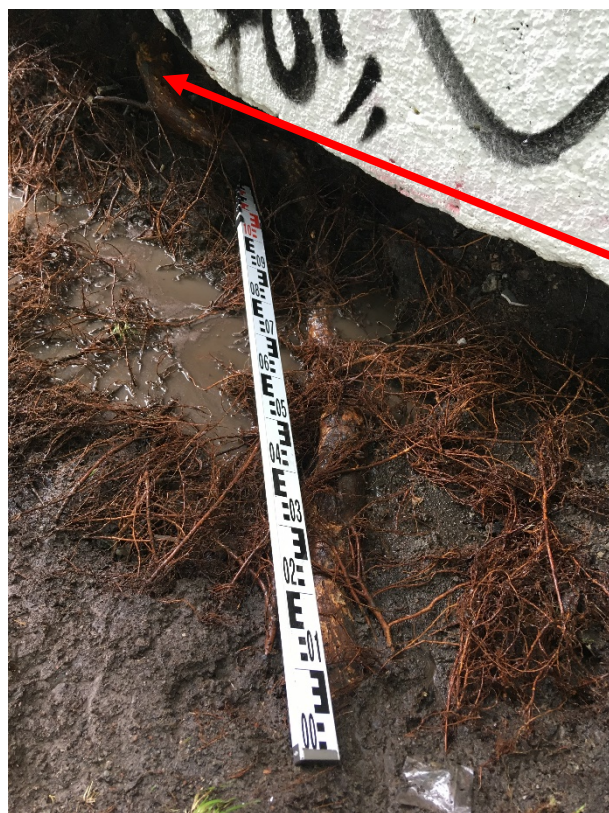
Bild 19 En rot ca 9 cm i diameter växer in under muren
