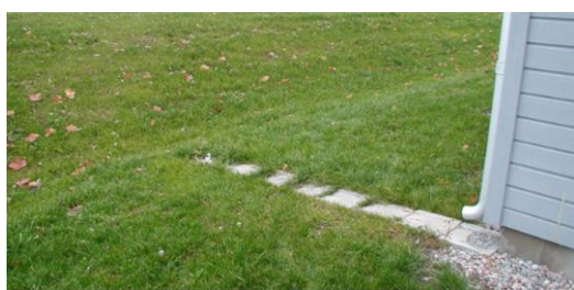
Figur 21 Utkastare som avleder dagvatten till grönyta (Stockholm Vatten, stockholmvattnochavfall.se)
