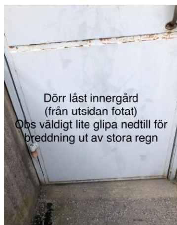
Figur 16 Port på fastighetens östra sida kan släppa ut små mängder dagvatten när porten är stängd
