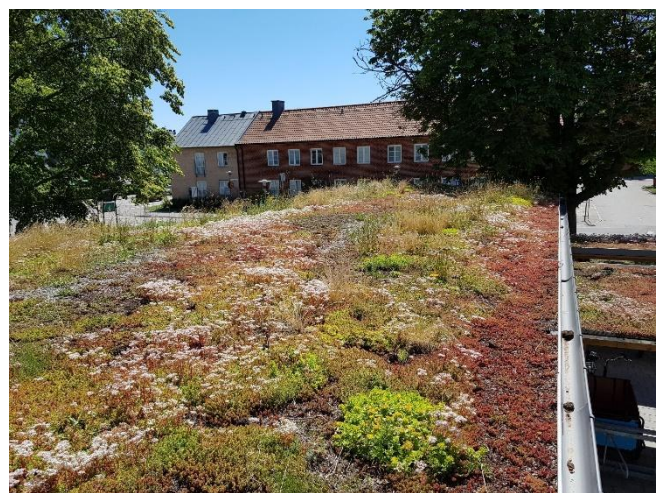
Figur 19 - Örtsedummatta i Malmö, Sedummix med inslag av torktåliga perenner på 25% av ytan (normal substrattjocklek 3 cm, vid perenner substrattjocklek 11 cm) (bild: Sweco).
