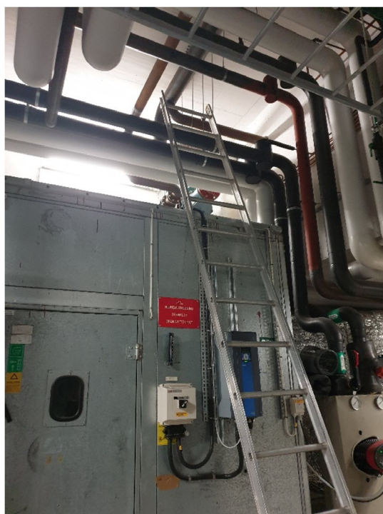
Bild 4. Inkommande sprinkler och brandledning.
