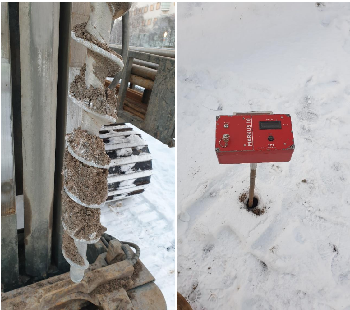
Figur 3. Fyllnadsmaterial i bilden till höger och mätning av markradon med mätinstrument MARKUS 10 i provtagningspunkt 20M09.
