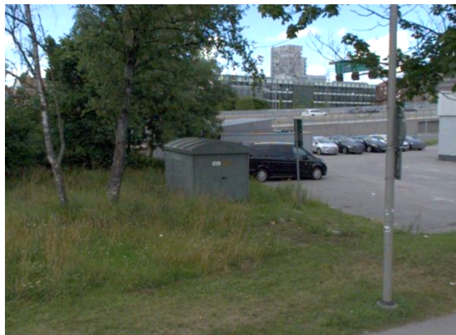
Befintlig elnätsstation vid Kontrollvägen som avses ersättas med en större station för att täcka upp för behovet av tillkommande bebyggelse.
