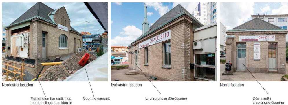
Platsbilder med redovisning av restaureringsbehov.
