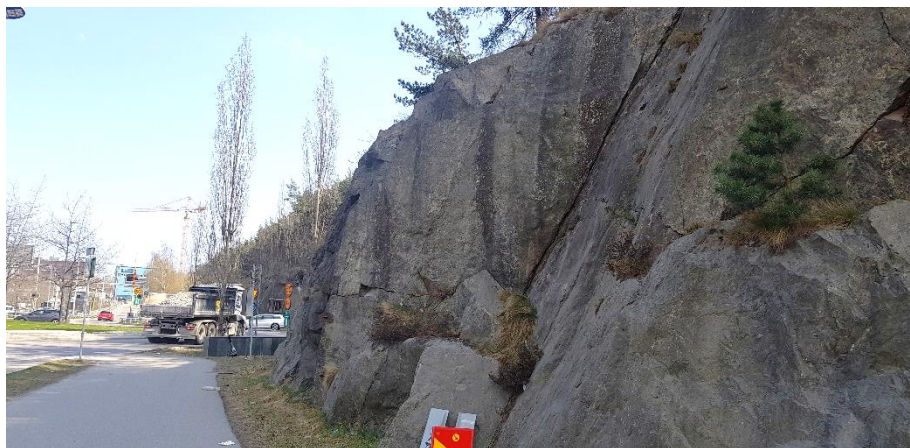
Figur 5. Bild från aktuellt område, tagen 2021-04-21. Bilden visar exempel på plant brott.
