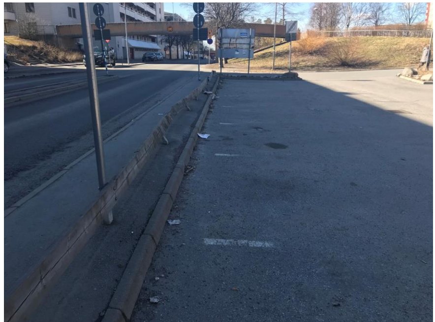
Figur 14 – Parkeringen riskerar i dagsläget att drabbas av inströmmande skyfallsvatten pga en liten skillnad i markhöjd.
