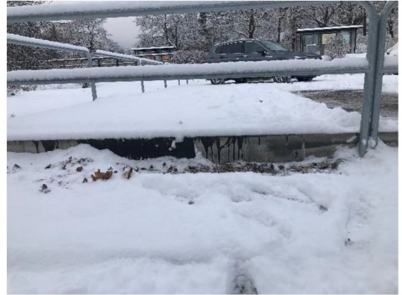
Bild 2. Kvarlämnad bottenplatta från nedbrunnen byggnad inom delområde 1
