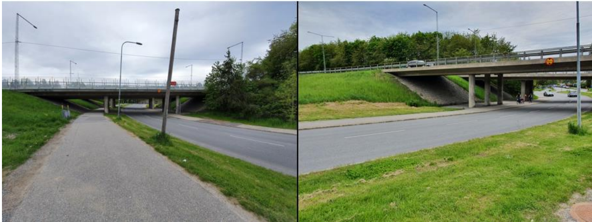
Figur 19. Bilder från platsbesök 2021-05-31. Flygfältsgatan under Tyresövägen. Till vänster vy från västra sidan, till höger vy från östra sidan.
