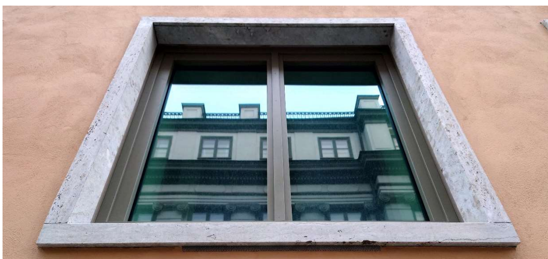
Ovan t.v. Den indragna volymen mot Rådhusgränd är tydligt avläsbar som ett tillägg. Ovan t.h. Rådhusgränd med Bondeska palatset t.v. och Ledamotshuset t.h. Nedan: Tillbyggnadens fönster mot Rådhusgränd med omfattningar av kalksten.
