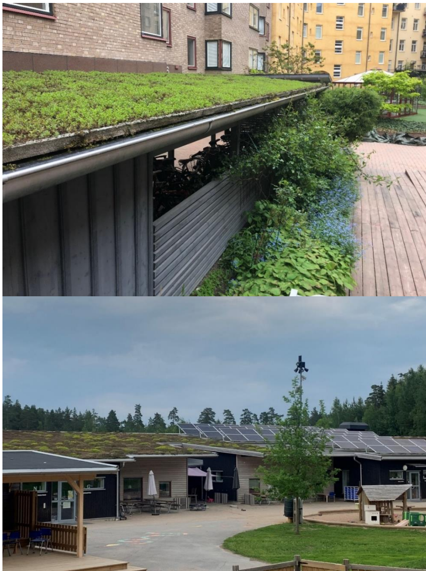
Figur 12. Grönt tak på cykelhus (övre) samt grönt tak i kombination med solceller på förskola (nedre). Bilder tagna av Bjerking.
