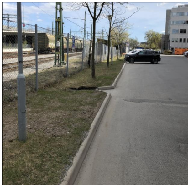
Figur 13 Släpp i kantsten och öppning från område ut mot rangerbangården.
