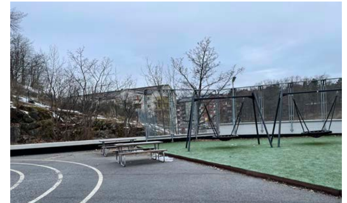
Fallskyddsområden ser ut att vara i underkant i mått och stötdämpningen är ev inte godkänd.
