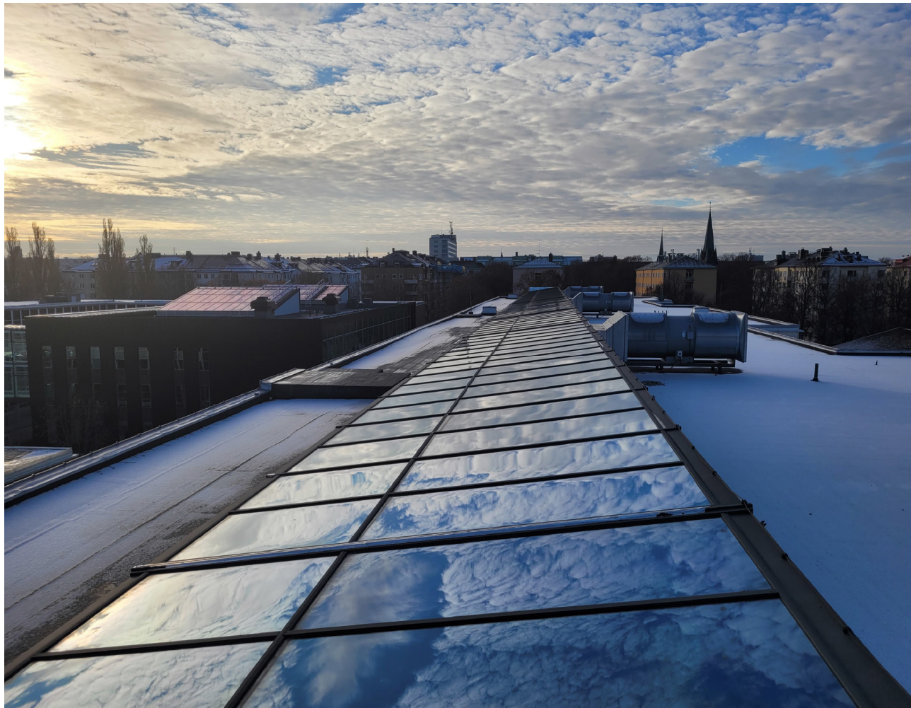
Taklandskap söder utöver den långa lanterninen som är asymmetriskt placerad, den ligger förskjuten mot öster.
