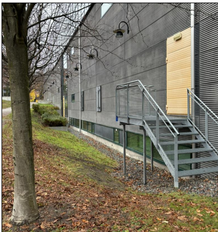
Figur 8.3 Bild över lågpunkt i anslutning till västra fasaden på byggnaden inom Tre Vapen 7. Foto: NIRAS Sweden.
