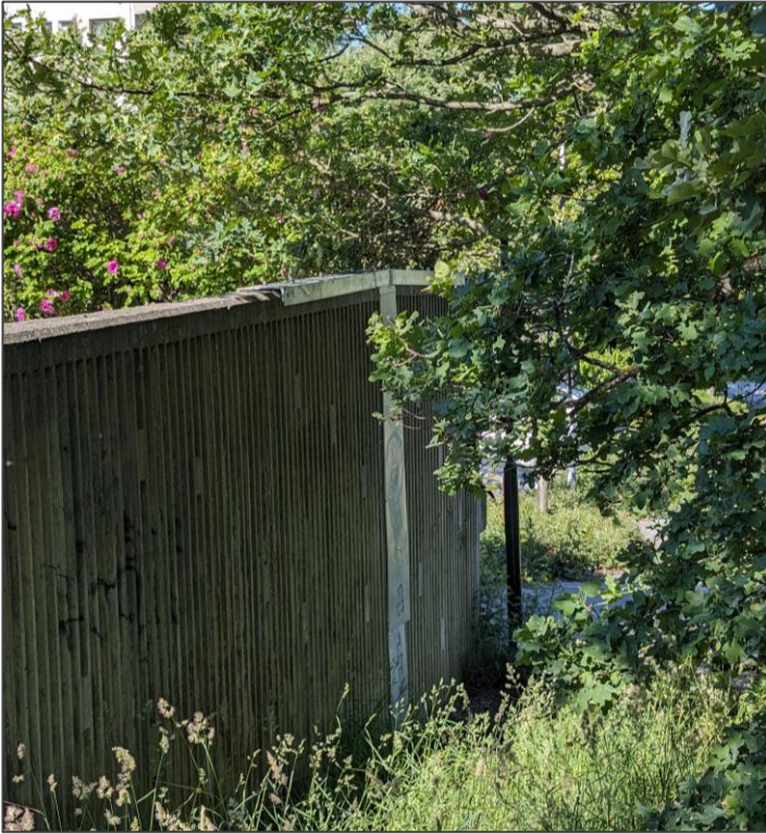
Figur 5.3. Stödmuren på parkeringens norra sida har behövt stärkas upp till följd av sättningar. Detta beror enligt fastighetskötare troligtvis på att dagvattenbrunnen på parkeringen är underdimensionerad.
