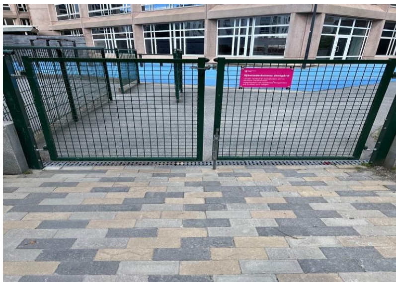
Figur 11 Befintlig dagvattenränna vid ingången till skolgården tillhörande Heliosgatan 22
