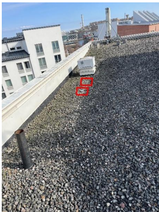
Figur 13 Takbrunnar på tak hus 1
