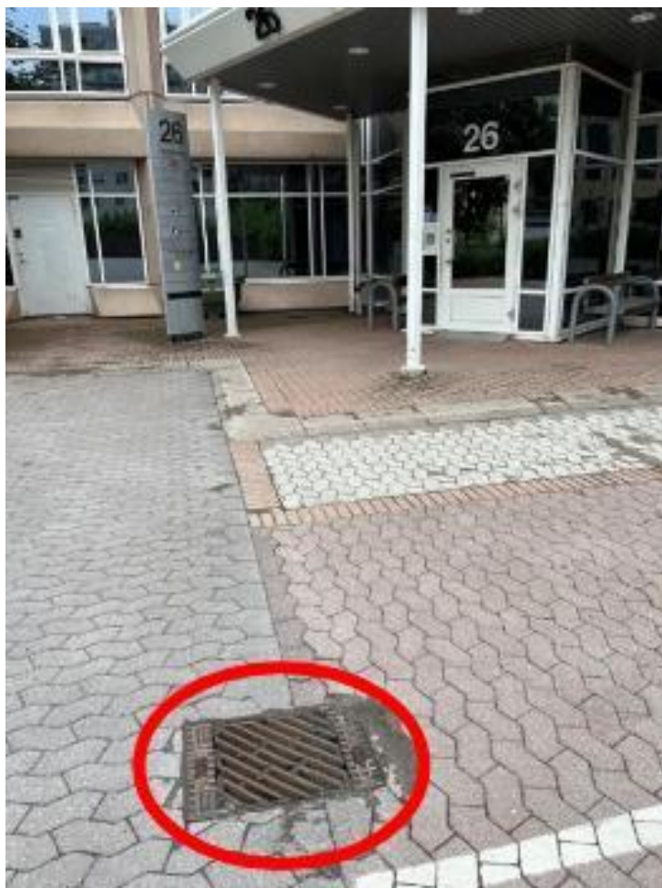
Figur 9 Befintlig dagvattenbrunn framför entré till Heliosgatan 26.
