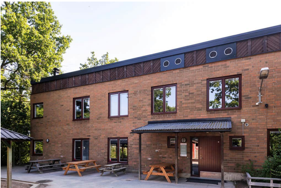
Fasad mot väster där hårdgjorda ytor ansluter till byggnaden. Nordiqus.
