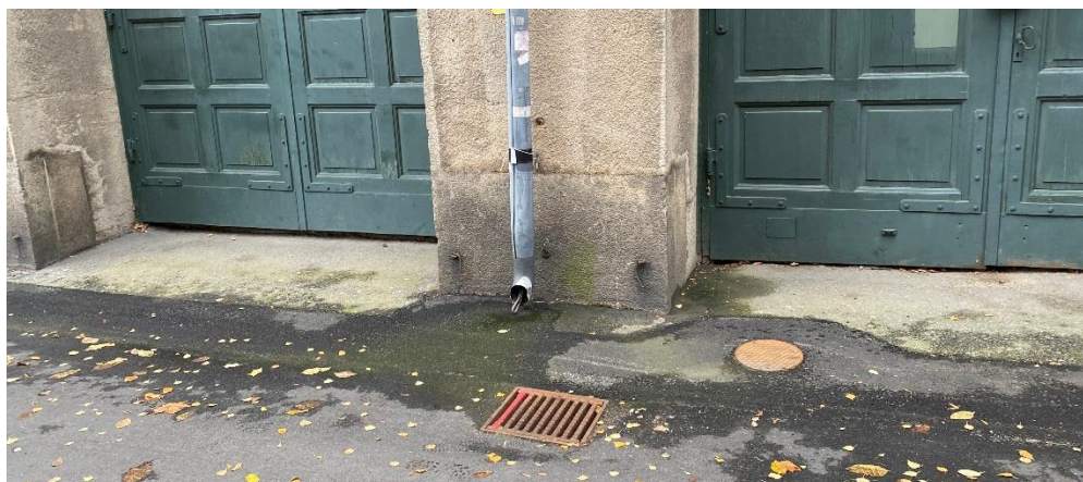
Figur 8 Del av stuprör från fastighet på innergården med stuprör som släpper dagvatten direkt på markytan där vatten leds ytligt till dagvattenbrunn.
