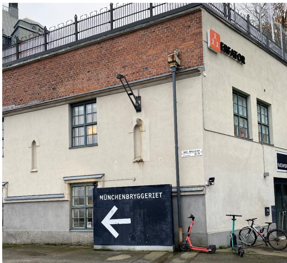
Figur 10 Stuprör som omhändertar dagvatten från mynning i den nordvästra muren, Dagvatten leds via rännedal ut till Söder Mäljarstrand.
