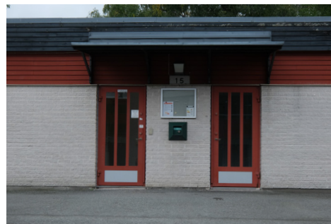
Servicehuset har bevarade träpartier under taksargen. Motsvarande partier på bostadshusen har bytts mot plåt.
