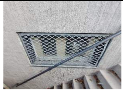
Bild 46. Nedgång till skyddsrum mm i G3, fönsterkitt med asbest.
