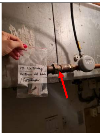
Prov 23. Lintätning rörskarv, fläktrum.
