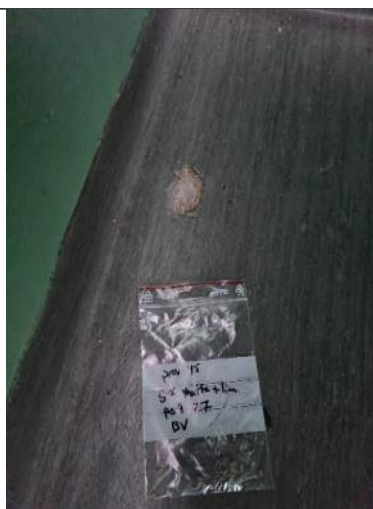
Prov 45. Grå matta+lim trapphus, innehåller asbest.
