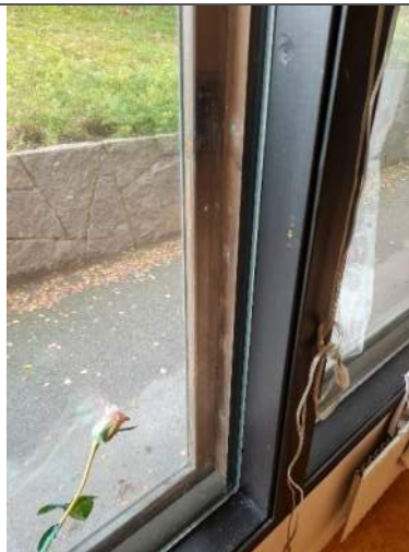
Bild 30. Äldre isolerruta med PCB-innehåll i lokalen.
