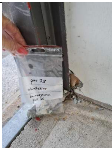
Prov 33. Eternitskiva barnvagnsrum, innehåller asbest.
