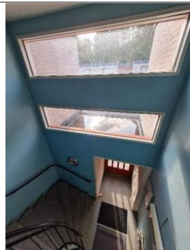
Bild 9. Översiktsbild trapphus från 1 tr. Isolerrutor med PCB-innehåll.
