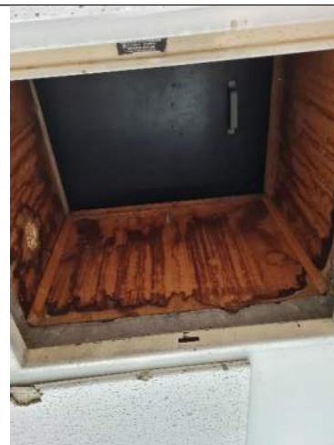
Bild 12. Uppgång till tak, fuktfläckar på virke.
