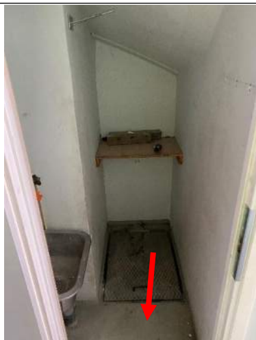
Prov 47. Samlingsprov betong trapphus, innehåller krom VI.
