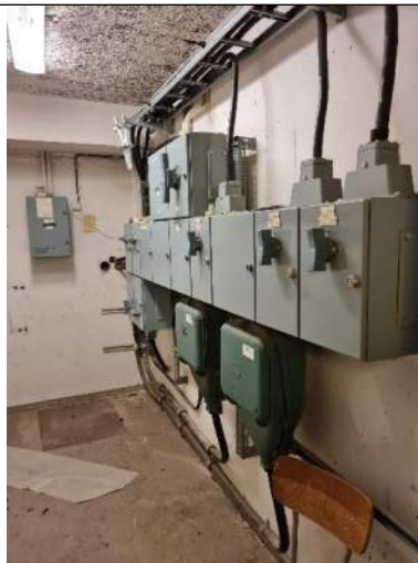
Bild 48. Elcentral, blymantlade elledningar finns. Asbest och olja kan finnas i äldre elinstallationer.
