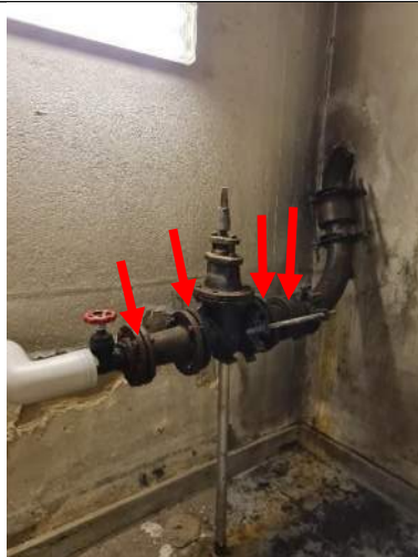
Bild 45. UC G2, inkommande vatten. Asbest i flänspackning i rörskarvar.
