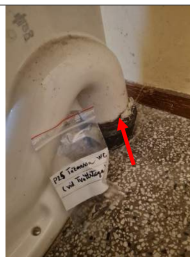
Prov 25. Tätmassa WC tvättstuga.
