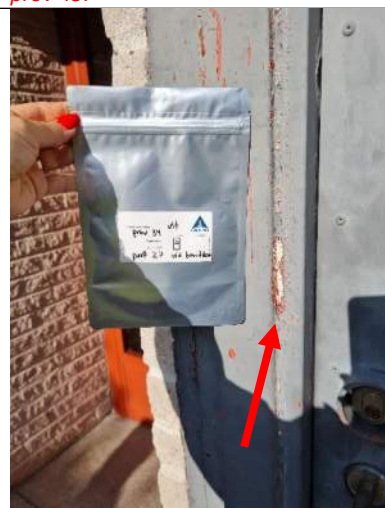
Prov 34. Vit fogmassa vid branddörr.
