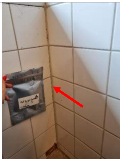
Prov 20. Fogmassa tvättstuga.
