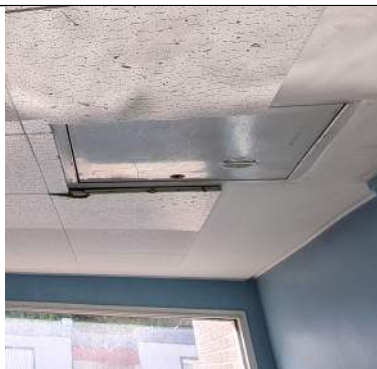
Bild 11. Taklucka i trapphus bedöms vara asbestinnehållande.
