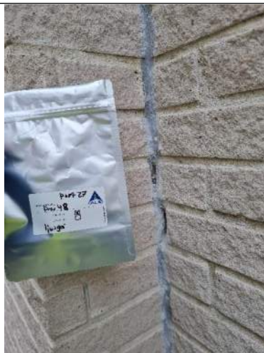
Prov 48. Ljusgrå fogmassa, innehåller klorparaffiner, dock under gränsen för farligt avfall. Samma typ av fogmassa som prov 28.
