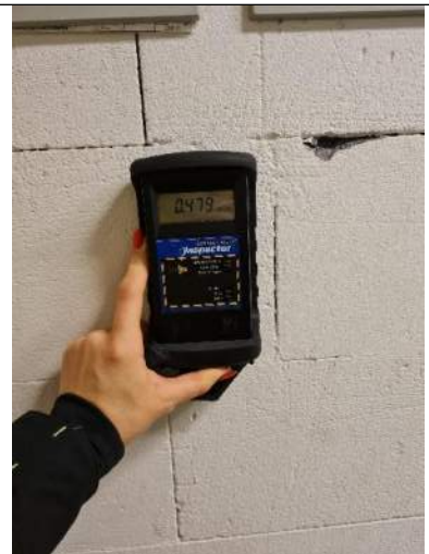
Bild 49. Elcentral. Gammamätning av blåbetongvägg, påvisar förhöjda värden.
