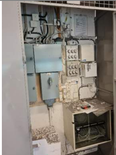
Bild 27. Elcentral i tvättstuga. Asbest och olja kan finnas i äldre elinstallationer.
