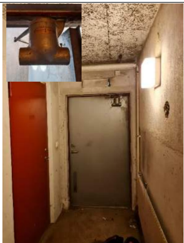
Bild 50. Äldre branddörr och dörrstängare (se förstoring) som troligen innehåller PCB-olja.
