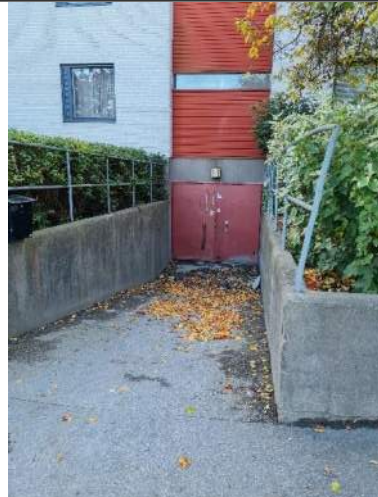
Bild 21. Baksida, asbestinnehållande internitskivor bakom röd plåtpanel samt äldre branddörrar till lokal.
