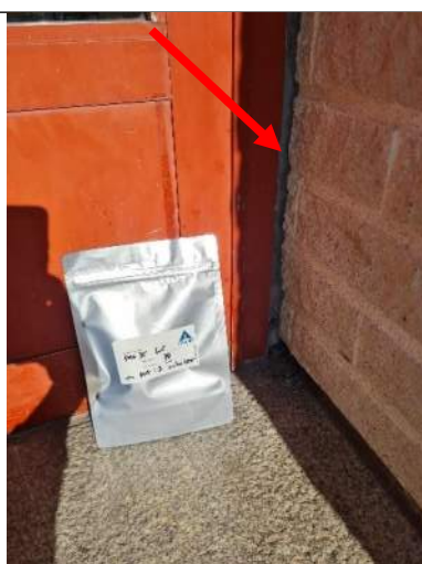
Prov 35. Grå fogmassa, entré utv. innehåller klorparaffiner.
