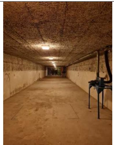
Bild 52. G4, skyddsrum. Skyddsrumsfäkt innehåller olja och ev. asbest.
