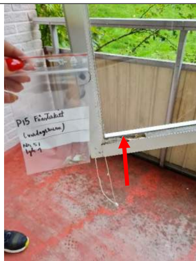
Prov 15. Fönsterkitt, innehåller asbest.
