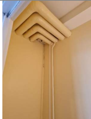
Bild 28. WC tvättstuga, äldre rörböjar och rörändar med asbestinnehåll.
