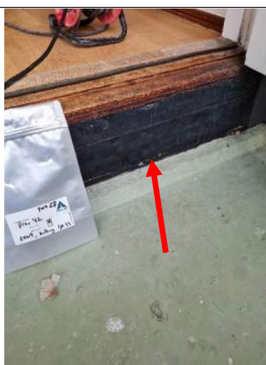
Prov 42. Svart fogmassa, innehåller klorparaffiner (se även prov 5).
