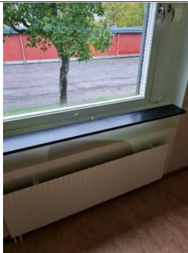
Bild 5. Asbestinnehållande fönsterbänk av eternit.
