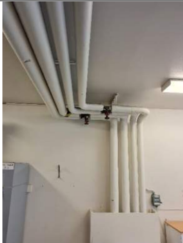
Bild 26. Äldre rörböjar och rörändar med asbestinnehåll i tvättstuga.
