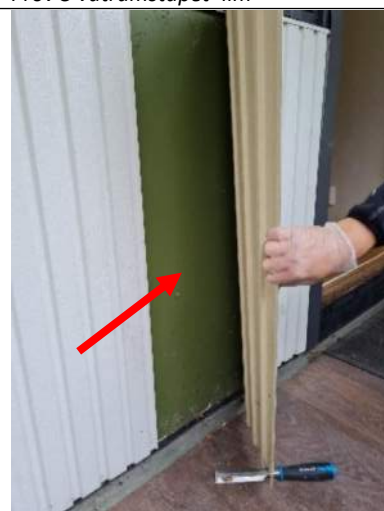
Prov 6. Eternitskiva bakom plåtpanel innehåller asbest.
