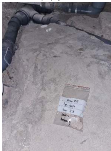
Prov 27. Betong badrum, innehåller krom VI.
