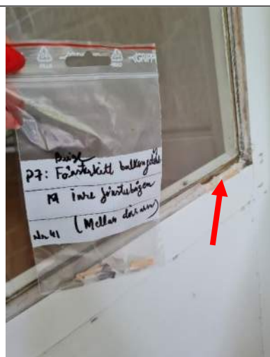
Prov 7. Fönsterkitt inre bäge, innehåller asbest.
