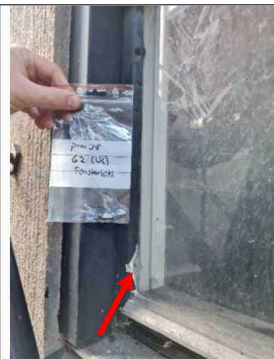
Prov 38. Fönsterkitt, G2, innehåller asbest.
