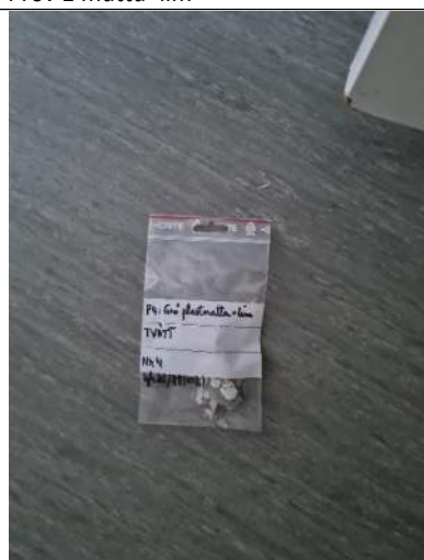
Prov 4. Grå matta+lim, tvätttrum, innehåller asbest.
