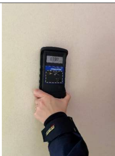
Bild 13. Gammamätning av blåbetongvägg i lgh, påvisar förhöjda värden.
