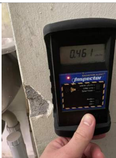
Bild 14. Gammamätning av blåbetongvägg i städskrubb i trapphus, påvisar förhöjda värden.
