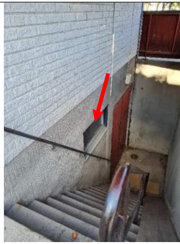
Bild 42. Nedgång till UC i G2, fönsterkitt med asbest.
