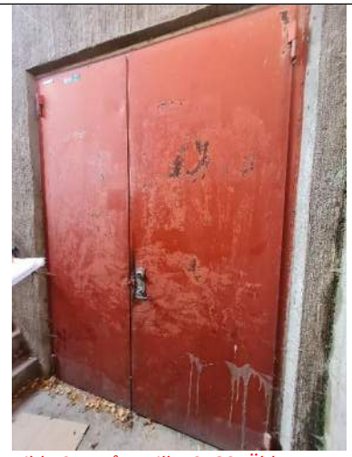
Bild 43. Ingång till UC, G2. Äldre branddörr med troligt asbestinnehåll.
