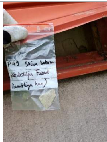
Prov 49. Internitskiva bakom plåtpanel i fasad, innehåller asbest.
