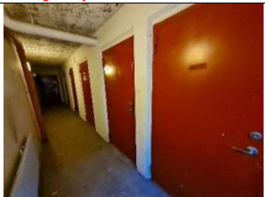
Bild 47. G3, korridor. Äldre branddörrar.
