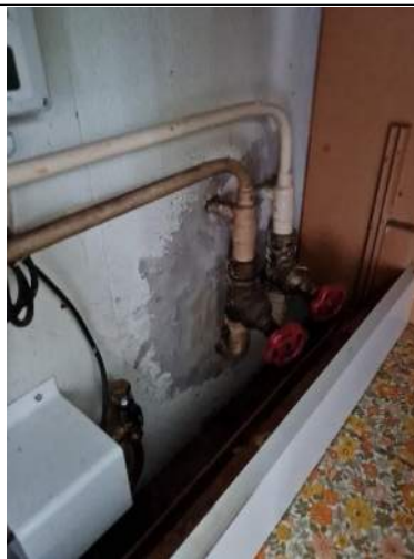
Bild 8. Ventiler i diskbänkskåp, ej möjligt att provta tätning.
