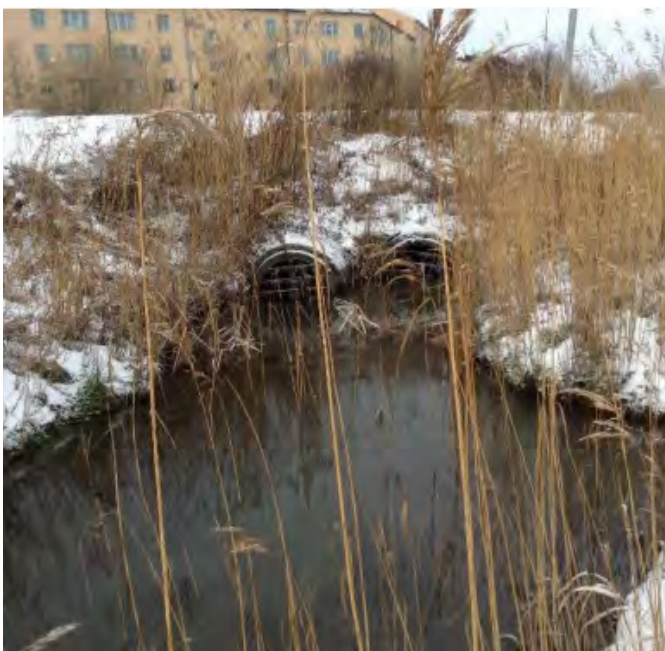
Figur 35. Vandringshinder VH 6:1 utgörs av ett galler där skräp kan fastna. Vid vandringshinder begränsas konnektiviteten också av snabbt strömmande vatten.
