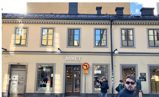
Slätputsad fasad från 1860-talet med klassicerande detaljer i målat trä: tandsnittsfris, slät list mellan de två våningsplanen och profilerade fönster- och dörrumfattningar.
