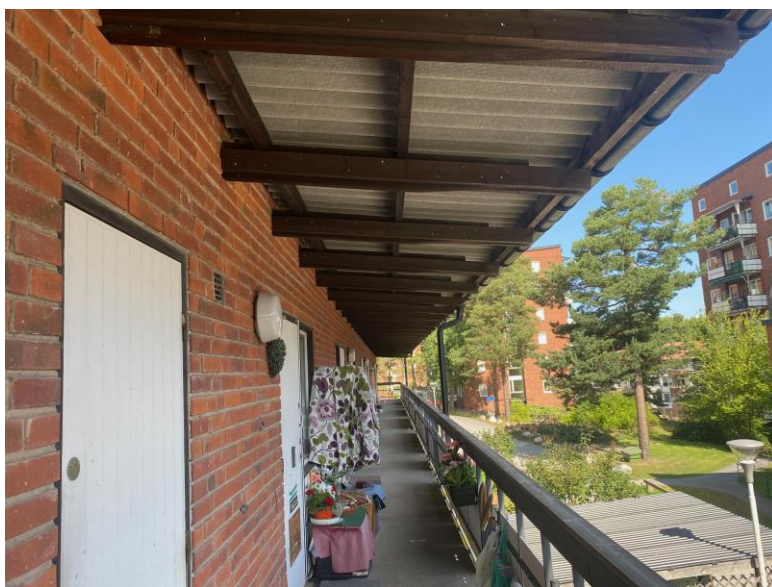
Vy över loftgångskorridor med synliga eternitskivor i undertak.
