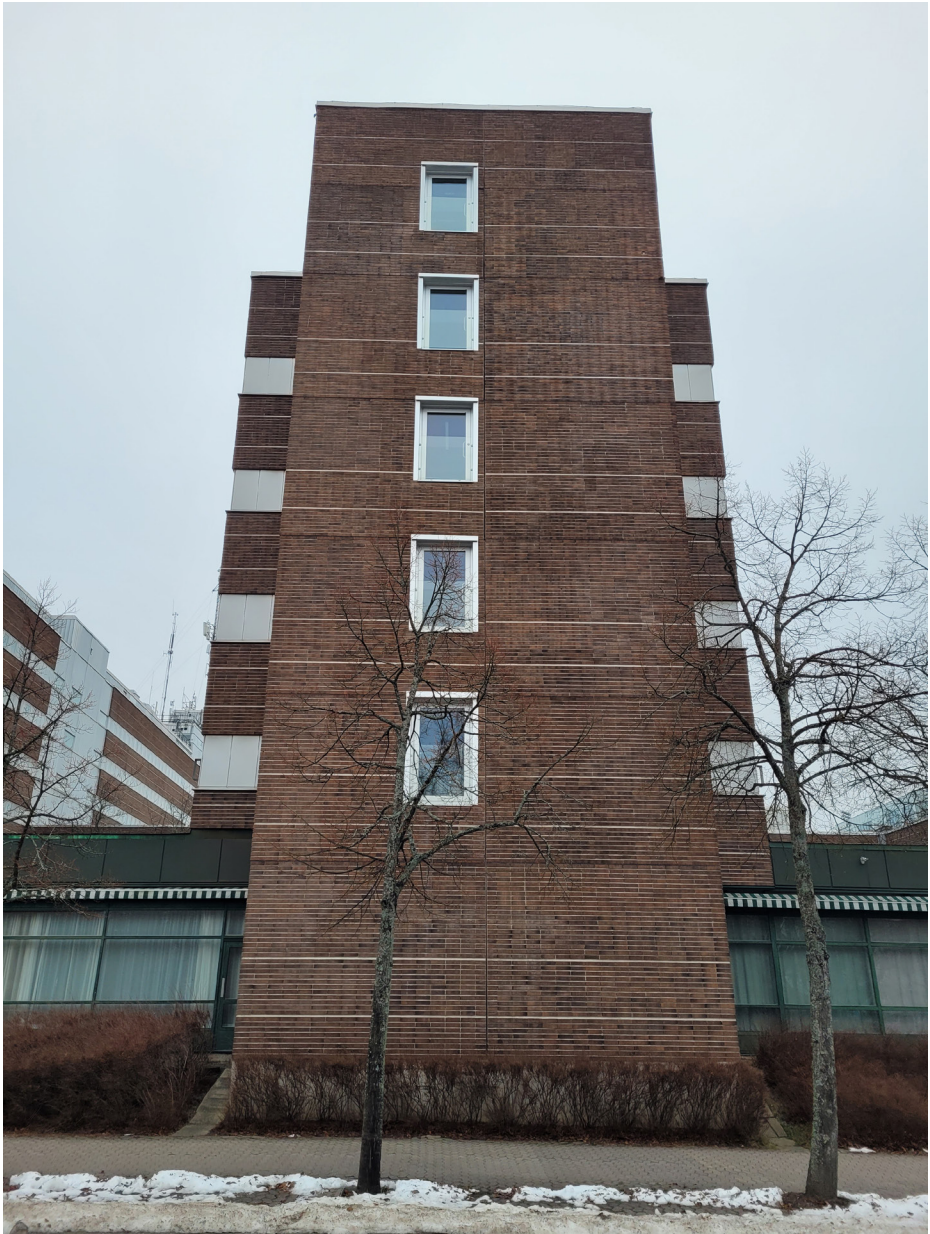
Figur 43. Gavel med sekundärt tillkomna och något klumpiga fönster. Gavelns tidigare skivkaraktär och murverkan är fortfarande avläsbar.
