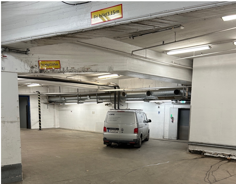
Figur 10: Befintlig varumottagningsyta med höjdbegränsningar och skador på takbalkar.
