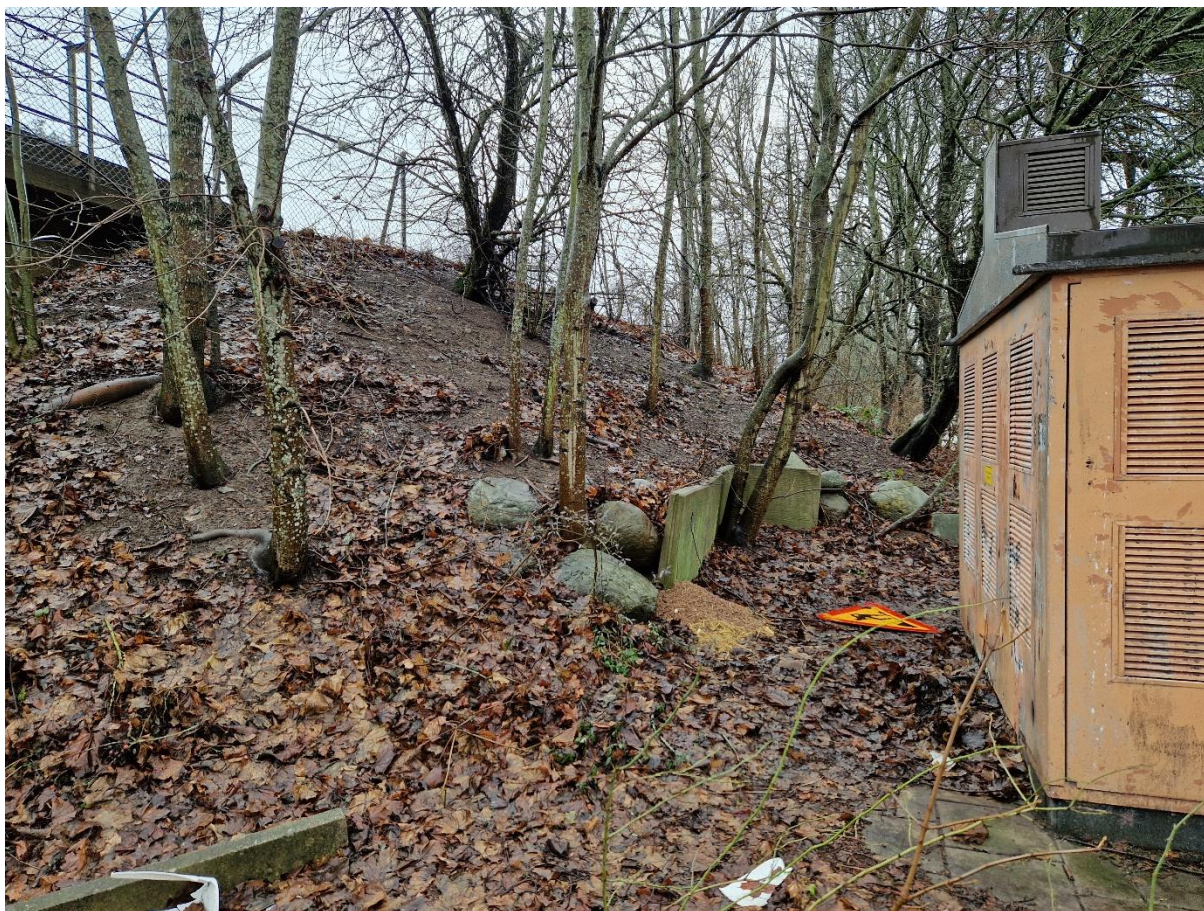
Figur 5-4 Elnätstation och tunnelbanebank med stödmur. Foto från platsbesök (2024-02-23).
