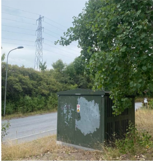
Befintlig elnätstation. I bakgrunden syns kraftledningarna på andra sidan Tyresövägen.
