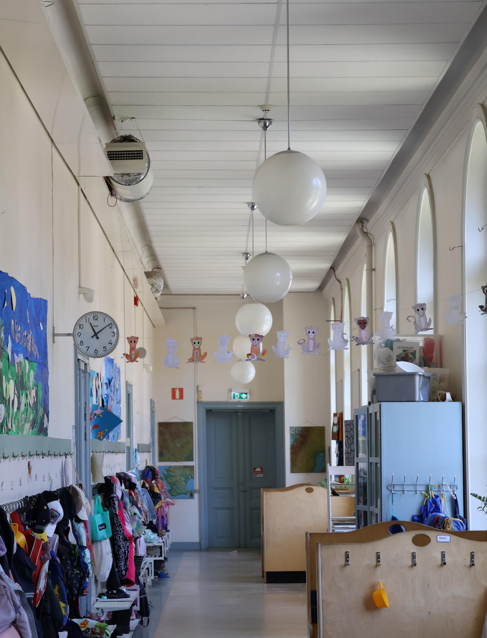
Korridor i Gustav Vasa skola i Vasastan, byggd 1886 och ritad av Axel och Hjalmar Kumlien. En viktig del i SISAB:s uppdrag är att bibehålla fastigheternas värde och funktion över tid
