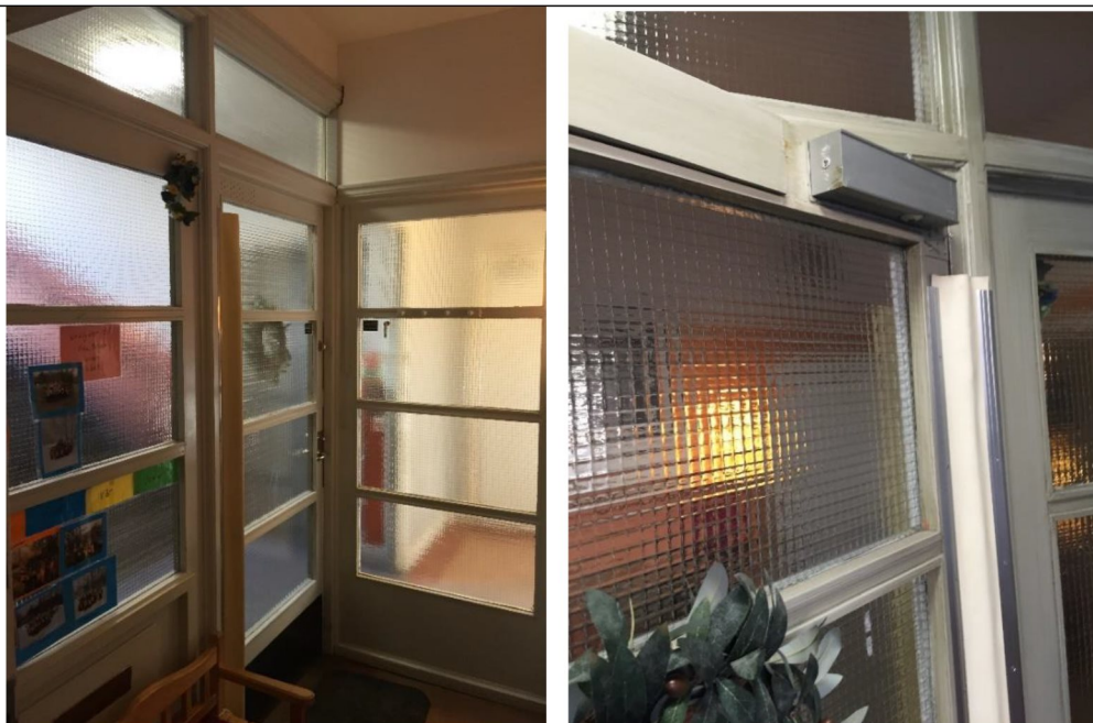
Brandcellsgräns ses över. Dörrstängare ur funktion
