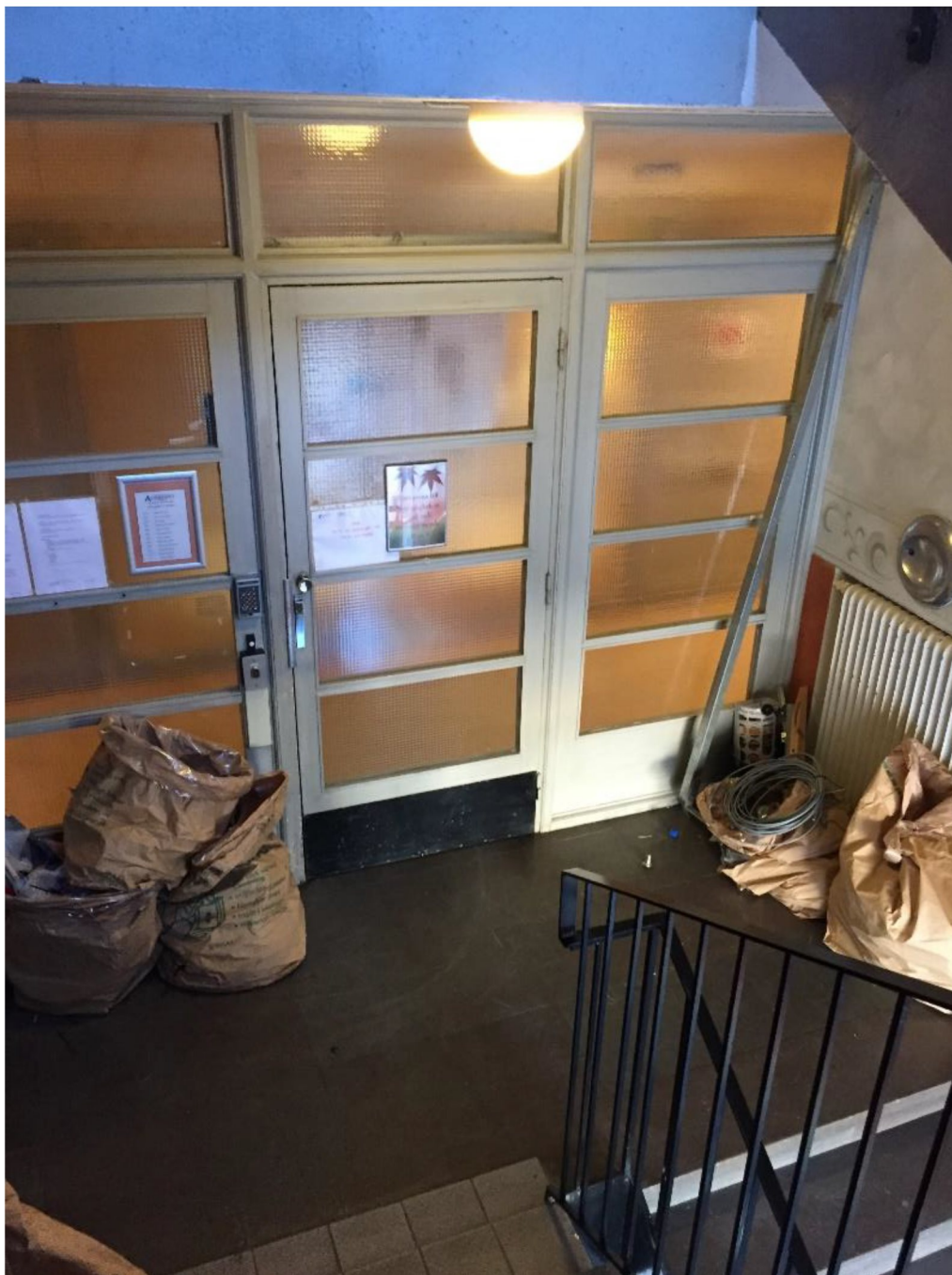
Brännbart material i utrymningstrapphus
