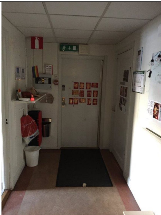
Förskolan Hörnets lokaler belägna på plan 1 skall förse med belysta eller genomlysta utrymningsskyltar med utförande enligt AFS 2008:13, skyltar och signaler. Nuvarande skylt lyser ej
