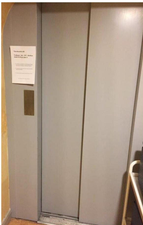
Hissar och hisschakt ska utformas så att skydd mot brand- och brandgasspridning mellan brandceller upprätthålls. Här stor risk för brand- och brandgasspridning, måste utredas vidare
