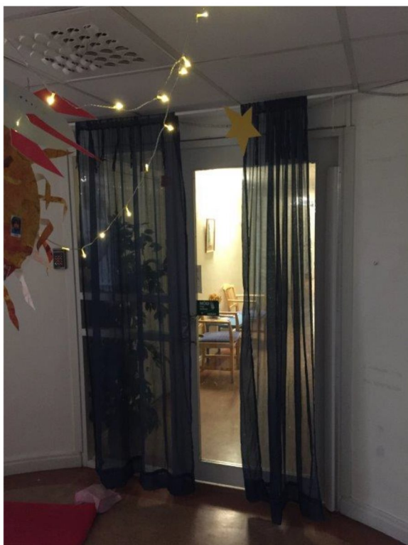
Förskolan Hörnets lokaler belägna på plan 1 skall förse med belysta eller genomlysta utrymningsskyltar med utförande enligt AFS 2008:13, skyltar och signaler. Här saknas erforderlig utrymningsskyltning
