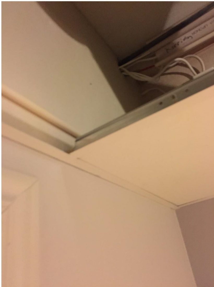
Otätta genomföringar över undertak
