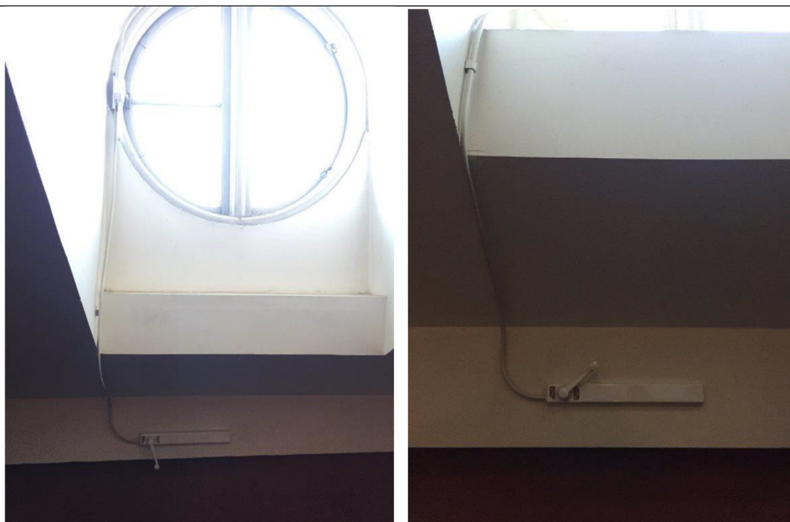
Trapphus har möjlighet till brandgasventilation
