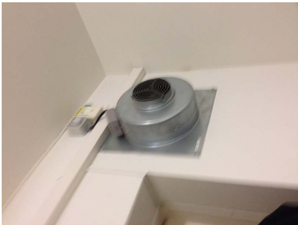
Figur 6: M23. Trapphusventilationsfläkt inifrån östra trapphuset.
