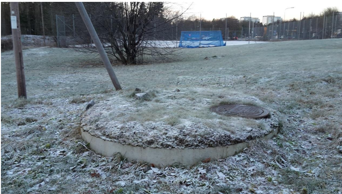
Tillsynskammare till ledning som löper under utredningsområdet.
