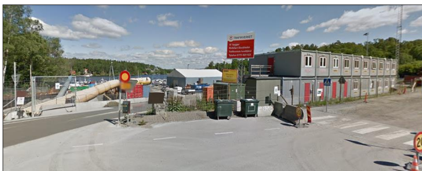
Bild mot norr vid entrén till Sätra varv vid Sättravarvsvägen/Sättraviksstigen där Trafikverket har etablerat ett arbetsområde i anslutning till tunnelmynningen.
