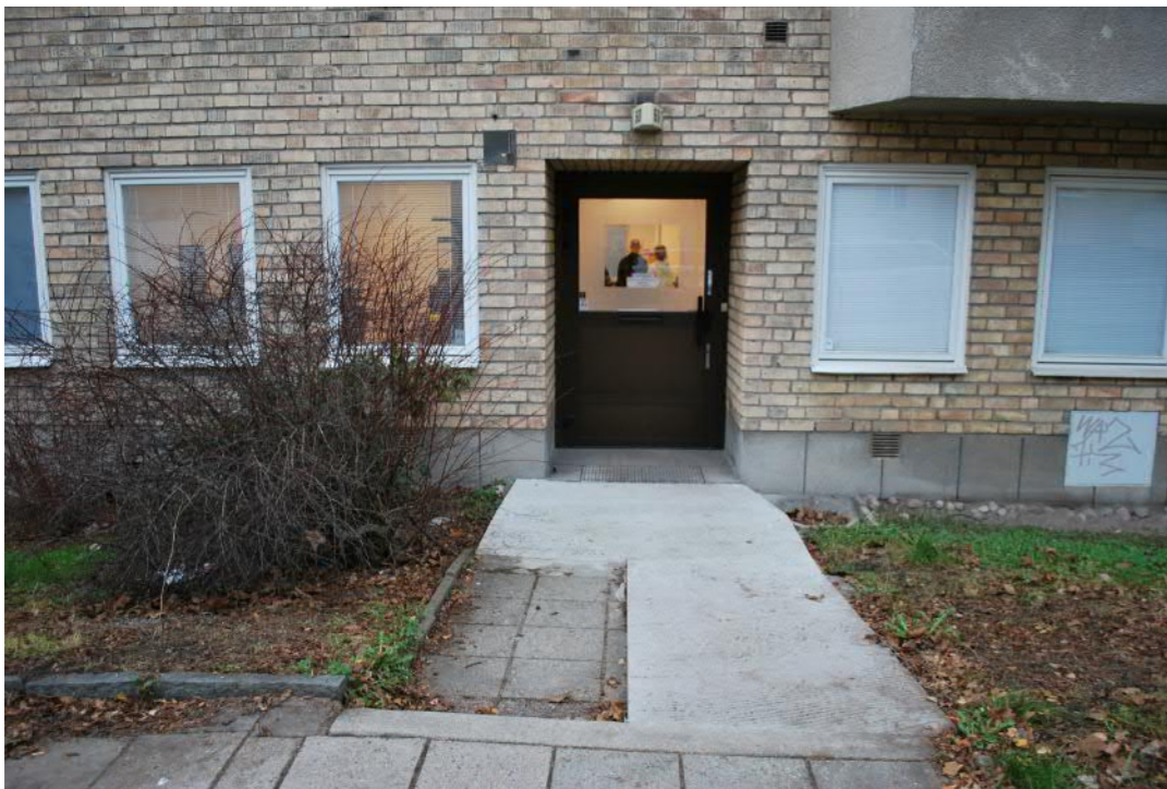
Mellan de två bostadsentréerna mot Sandhamnsgatan finns en entré till kontorslokalerna i bottenvåningen. Entréporten är utbytt till en glasad aluminiumport.
