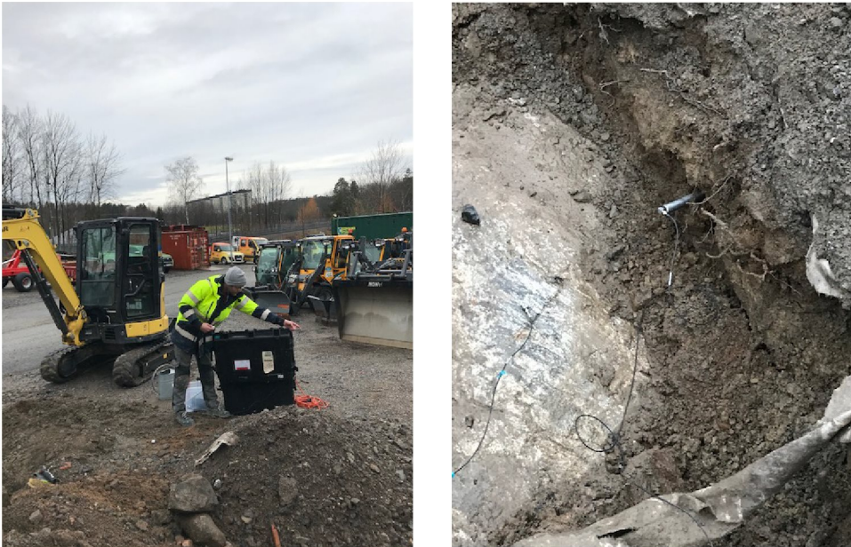
Figur 2 (vänster) provgropen med tågspåren i bakgrunden. (höger) gropen där accelerometrarna fästes på berg samt i den lösa marken med hjälp av ett spett.
