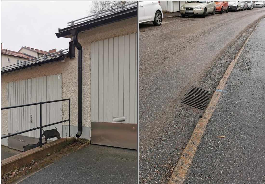
Figur 10 T.v. stuprör från garage. T.h. rännstensbrunn i Fågelstavägen. Foto: Norconsult
