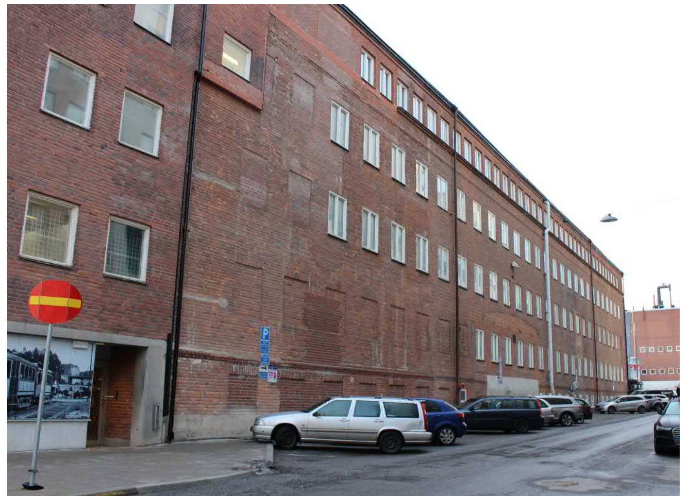
B42 (penicillinfabriken) sedd från korsningen Lindhagensgatan/Lenngrensgatan. Fasadpartiet är kraftigt påverkat av murverkslagningar. 1960-talstillbyggnades fasad (till vänster i bild) överlappar 1940-talets. två olika murförband har använts.
