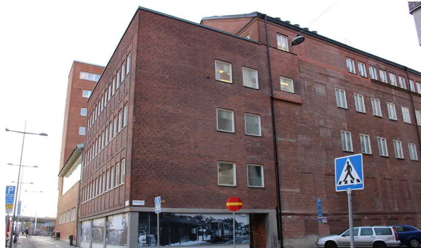
Byggnaden från korsningen Lindhagensgratan/Lennegrensgratan. Fasadpartiet är kraftigt påverkat av murverkslagningar. Notera hur tillbyggnadens munkförband kragar ut över den äldre byggnadens kryss-förband.
