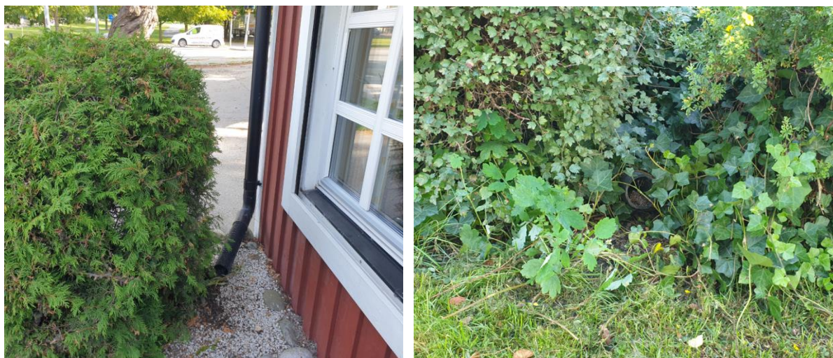
Figur 16 Utkastare leder dagvattnet ytligt till rabatter på byggnadens västra sida
