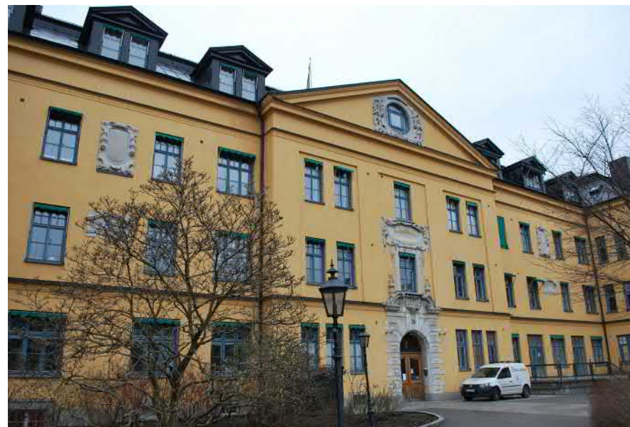
Gubbbuset med de befintliga, ursprungliga takkuporna som har påverkats av ovarsamma fönsterbyten.
