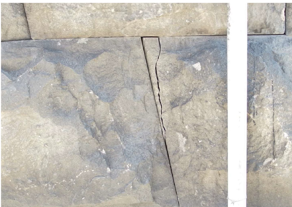
Bild 35. Krosskada i sten. Litt. 7.
