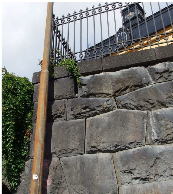
Bild 13. Hörn intill trappan mot Högalidsgatan. Skada med litt. 2.
