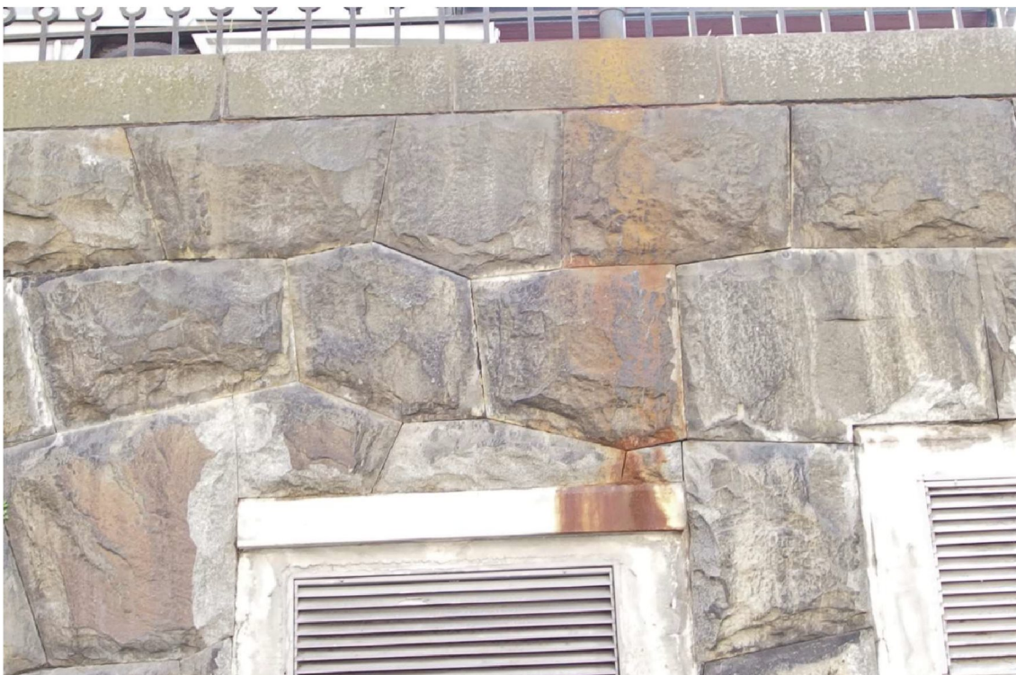
Bild 33. Vy av väggparti vid transformatorstationerna.
