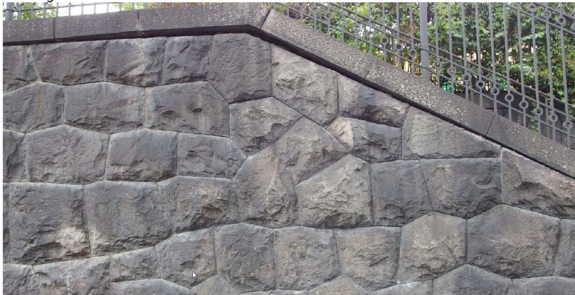
Bild 12. Skada med litt. 1.
