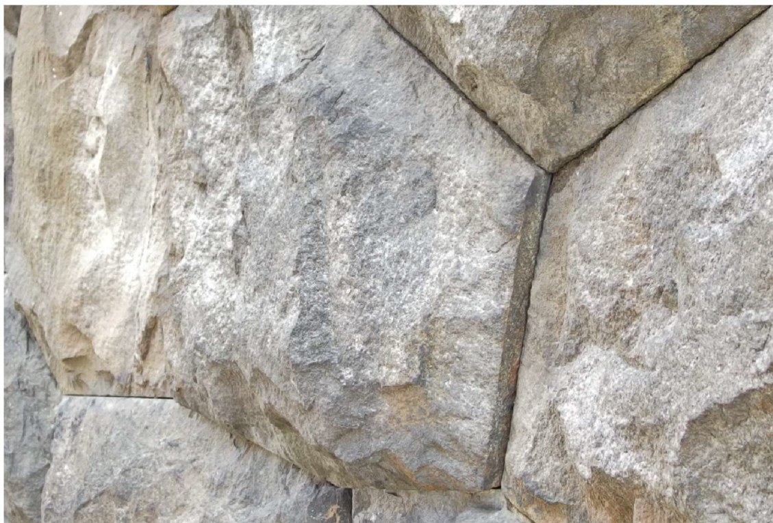
Bild 38. Lokalt utskjutande sten mot Varvgatan.
