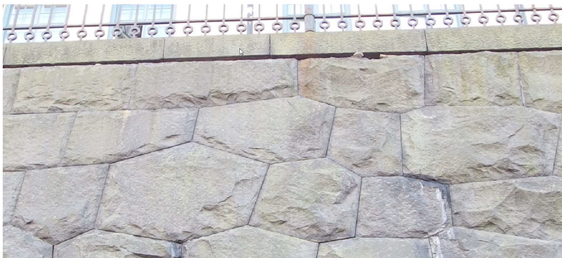
Bild 36. Skadad fog under krönsten, generell skada. Här ses även fuktgenomträngning.
