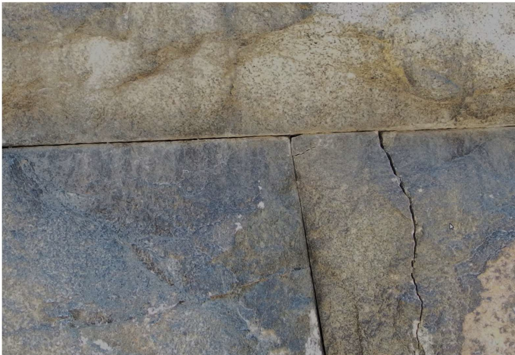
Bild 34. Krosskada i sten. Litt. 7.
