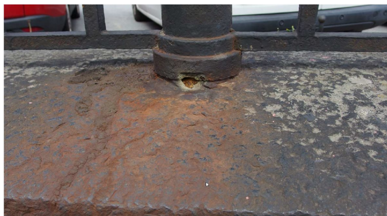
Bild 15. Begynnande korrosionsskada på smidesstolpe.
