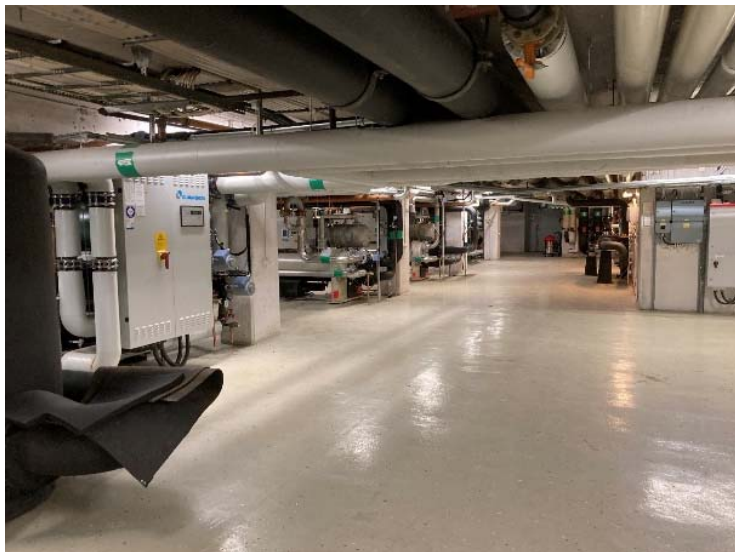
Foto 2. Undercentral i hus CDE.
