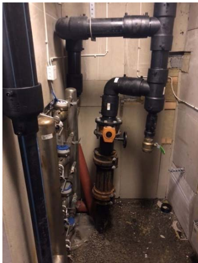
Foto 3. Vattenanslutning och mätarrum i garage.
