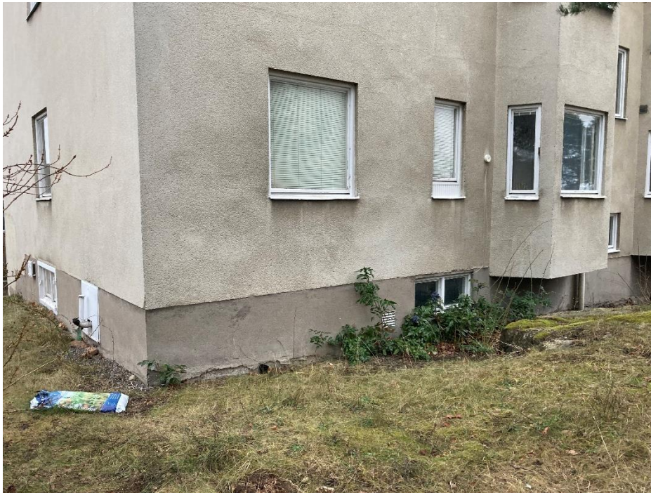
Figur 2-4. Stuprör som går in i byggnaden på nordvästra fasaden av den befintliga byggnaden.
