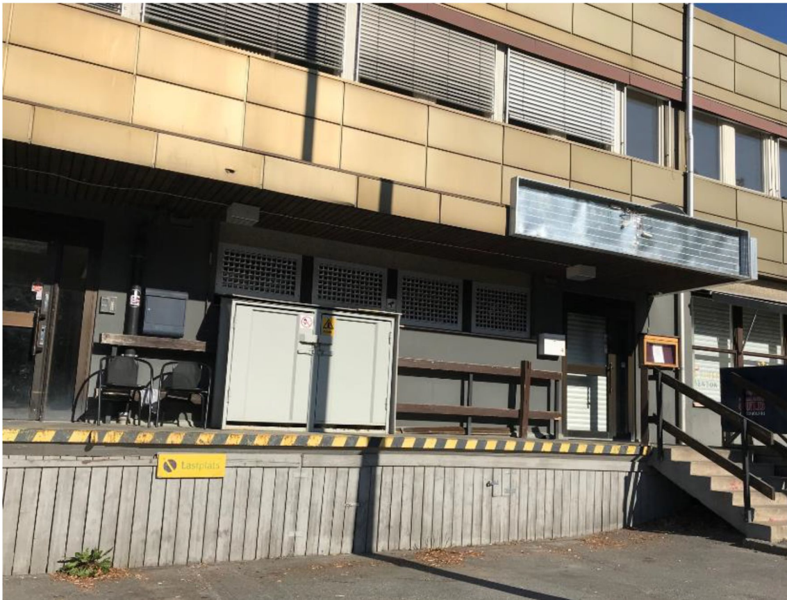
Figur 3. Utvändigt skåp med gasol. Källa: Tyréns
