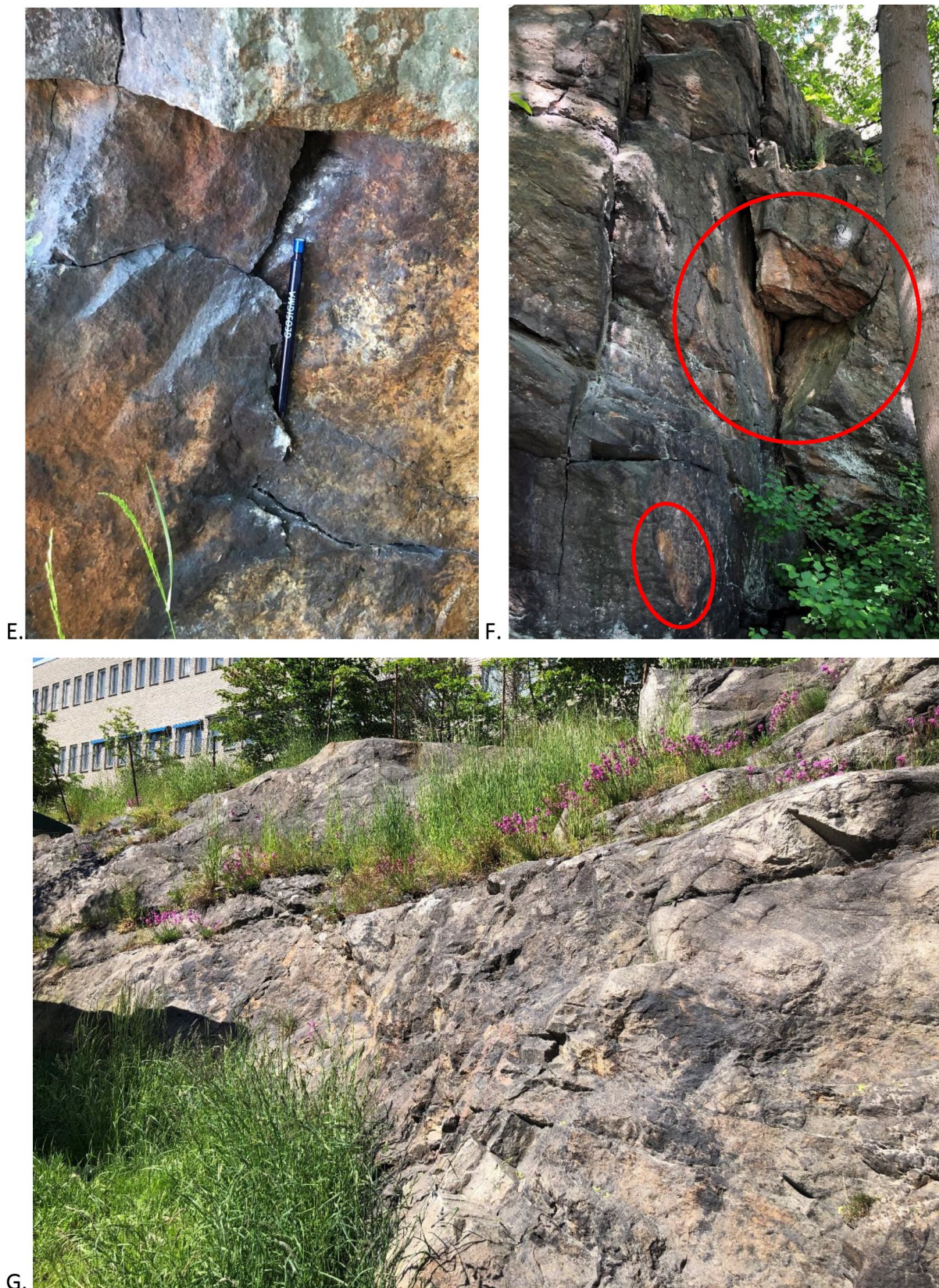
Figur 5-3. Längs Bällstavägen: E, F: Kraftig rostutfällning på bergytan; G: Mindre rostutfällning på stor del av bergytan.
